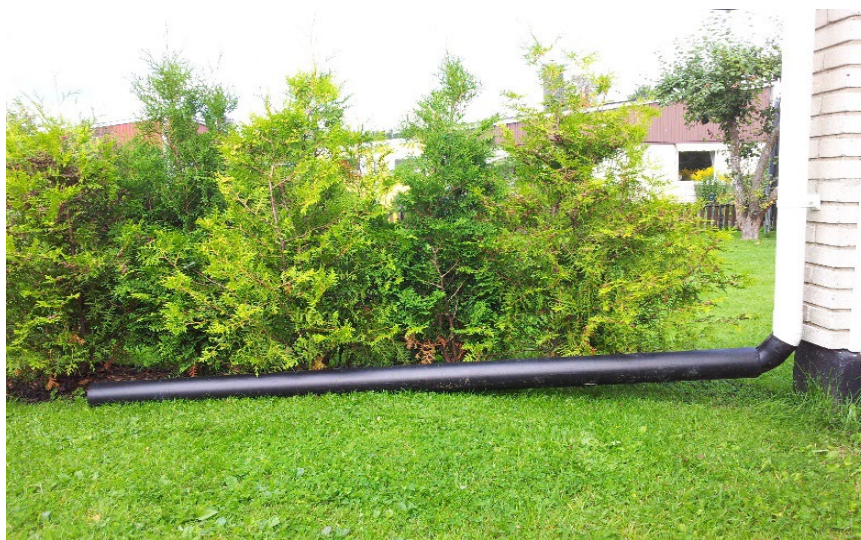
Foto 6.3 Utkastare göra att regnvatten infiltrerar över en större yta.
