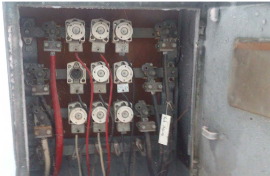
Kabelskåp av äldre modell. Samtliga delar i skåpet är strömförande.
