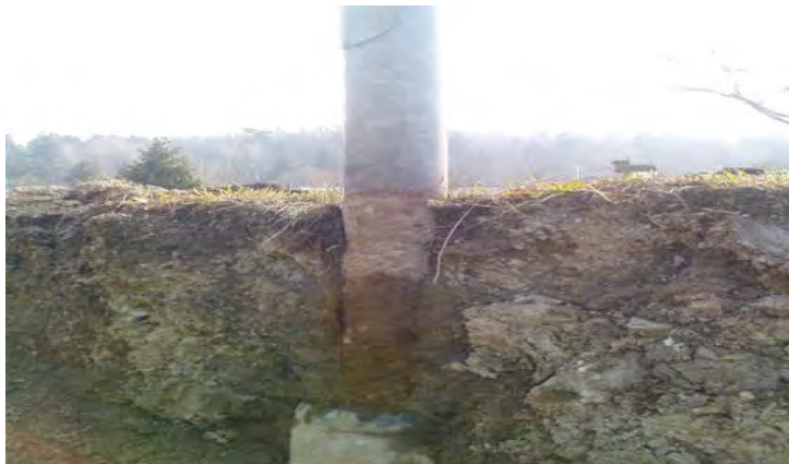
Exempel på hur enrostskada kan uppstå och utvecklas
