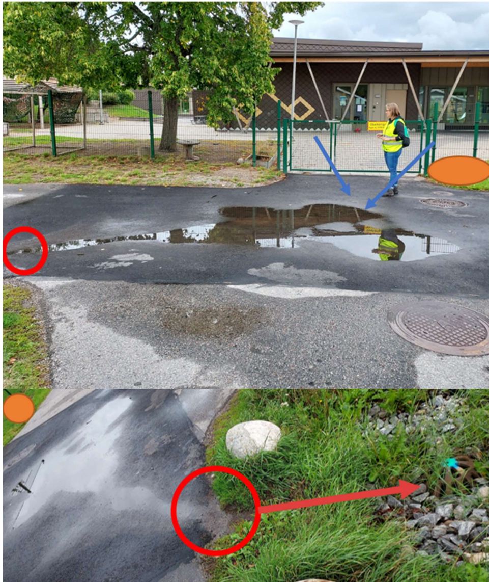
Figur 6-1 Foto över stående vatten från platsbesök 20210816
