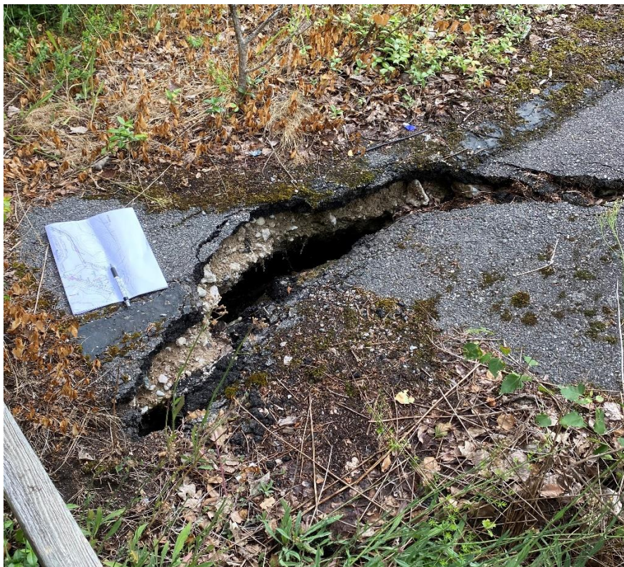
Bild 2. Pågående erosion – suffosion, NCE 2023
